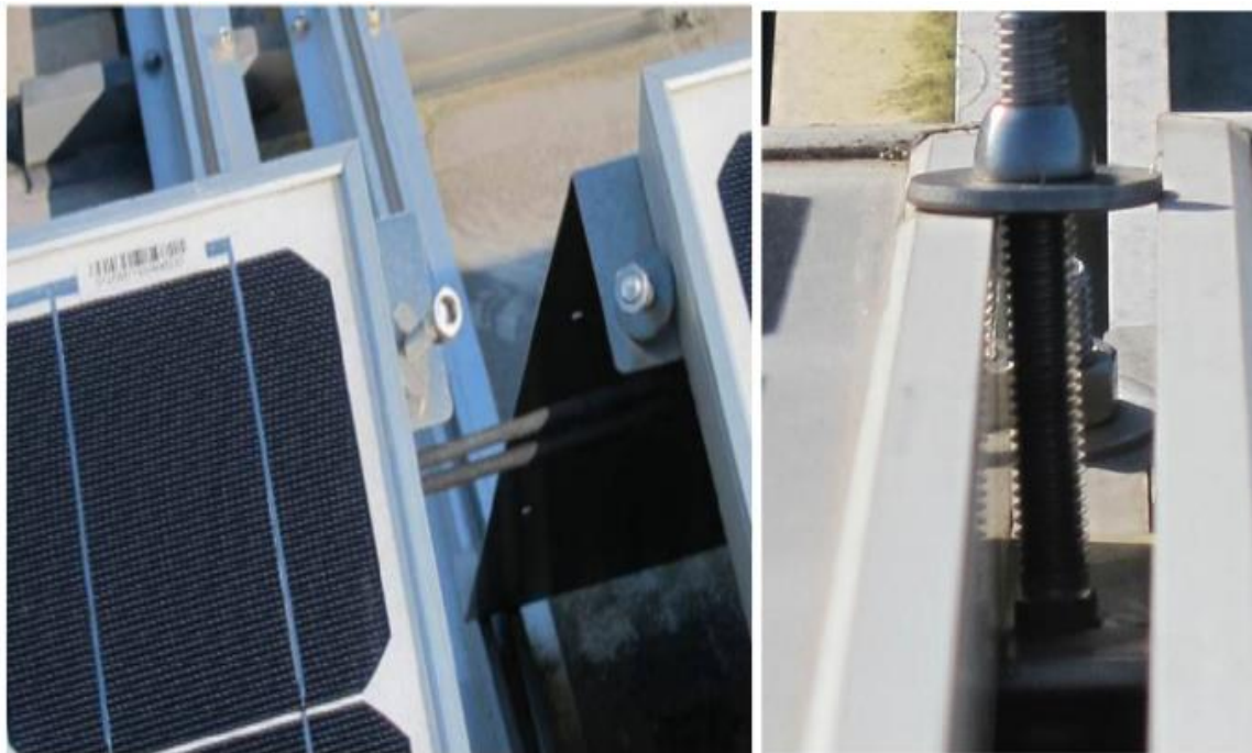
Figura 5.33 Malas prácticas de montaje.
