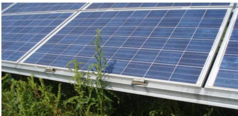
Figura 5.38 Vegetación provocando sombra a panel fotovoltaico.
