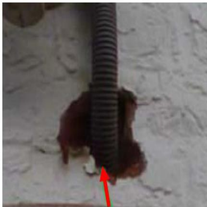
Figura 5.28 Canalización no sellada contra humedad.
