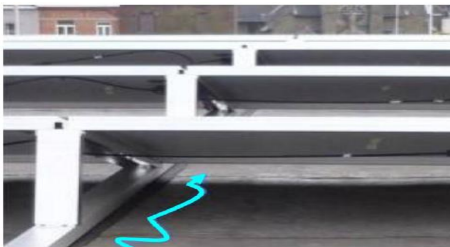
Figura 5.37 Espacio para ventilación y circulación de aguas lluvia bajo panel fotovoltaico.
