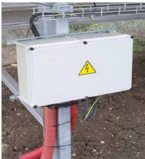
Figura 5.39 Señalización de riesgos en partes metálicas.
