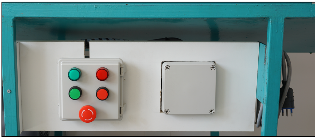
Fig. 1.4 Tablero de control eléctrico y cable de alimentación.
