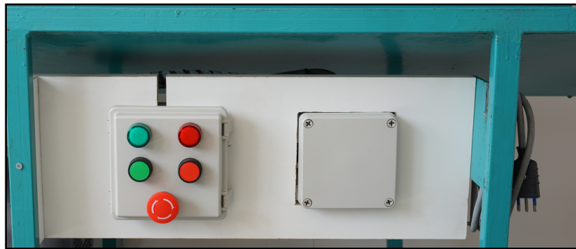
Fig. 3.13 Tablero de control eléctrico y cable de alimentación.
