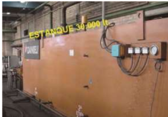
Imagen N°27: Estanque de la central OH4
