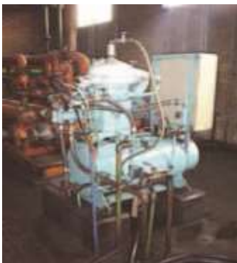
Imagen N°29: Depurador- centrífugo de agua
