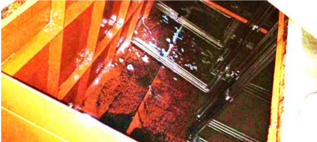
Imagen N° 35: Condición del estanque OH4 al momento de realizar el cambio de aceite.
