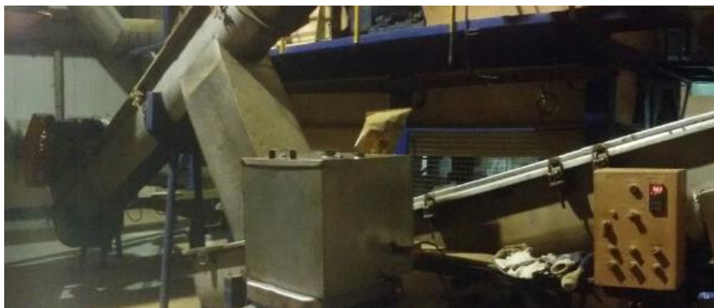
Figura 7. Lazo de Control Temperatura, estanque y panel de control.
