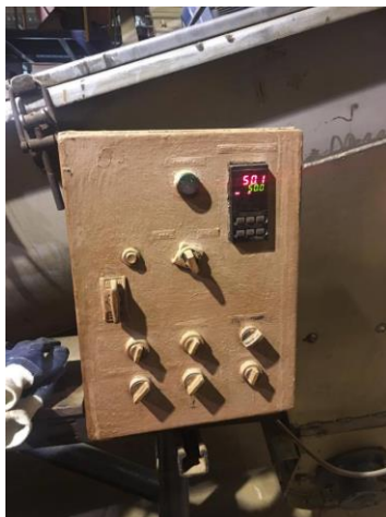
Figura 4. Controlador de Temperatura
