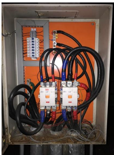
Fig. 6.15. Tablero de transferencia.
