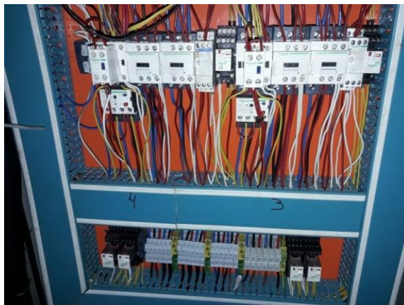
Fig. 6.5. Tablero de control Captación (Relés y Contactores).
