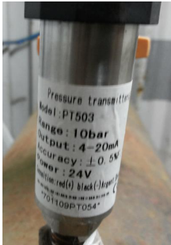
Fig. 3.1. Sensor de presión instalado en terreno.
