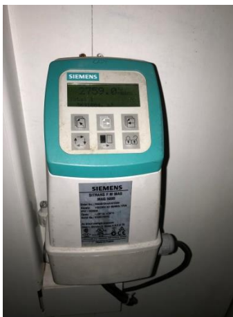
Fig. 6.6. Transmisor de Flujo Captación.
