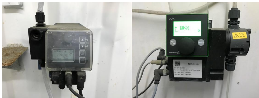
Fig. 6.7. Bomba Dosificadora de Cloro (Antigua/Nueva).
