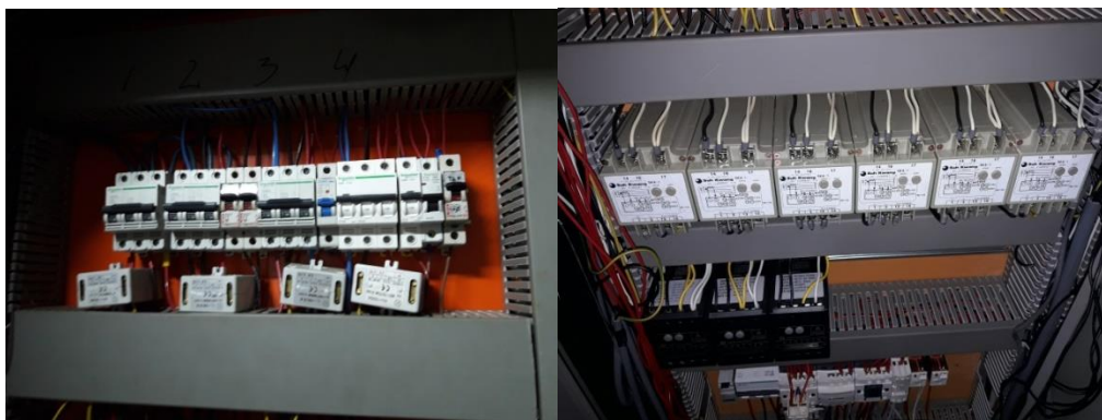
Fig. 6.4. Tablero de Control Captación (Transformador y Transductor de corriente)
