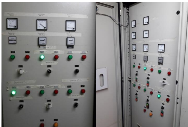
Fig. 6.11. Puerta de tablero Distribución modificado.
