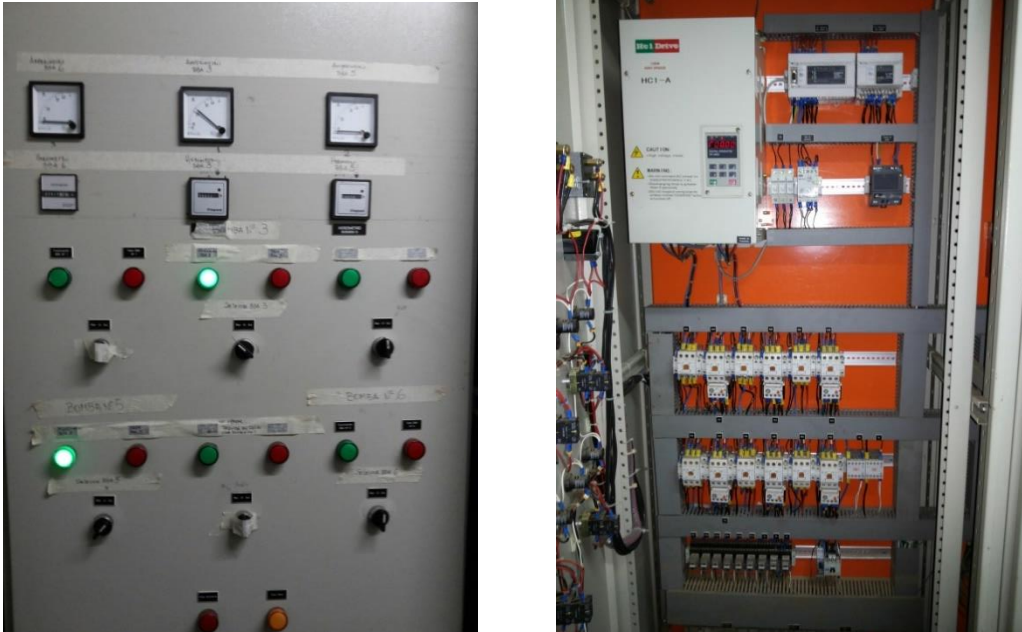
Fig. 2.5. Tablero de fuerza y control bombas de distribución.
