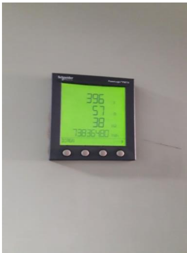
Fig. 6.14. Medidor de energía.
