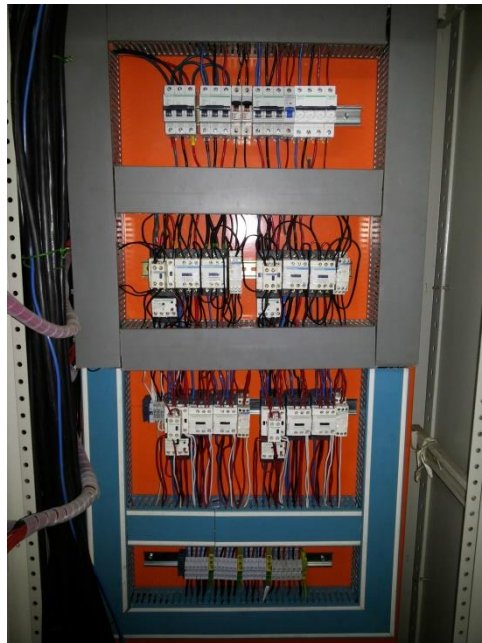
Fig. 2.2. Interior tablero fuerza y control bombas de captación.
