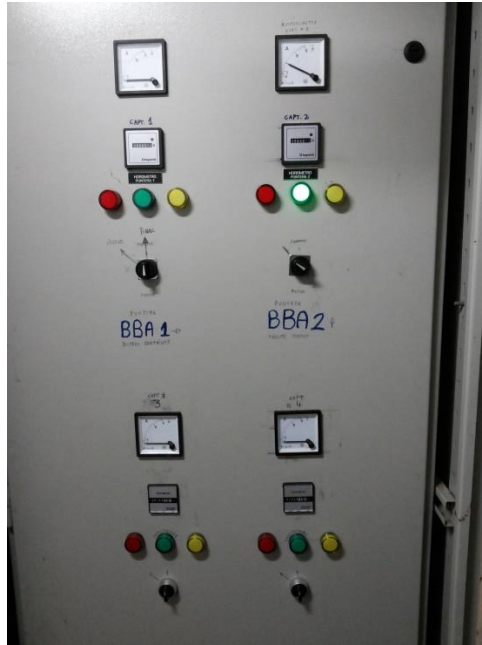
Fig. 2.1. Panel de control local bombas de captación.
