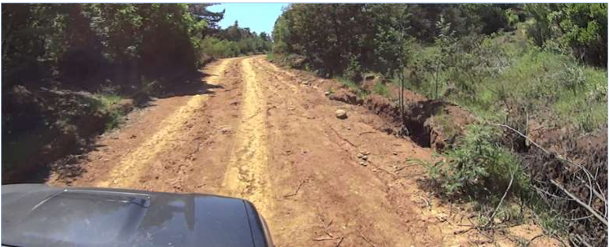
Figura 9C: Superficie natural de rodadura erosionada y presencia de cárcavas profundas.
