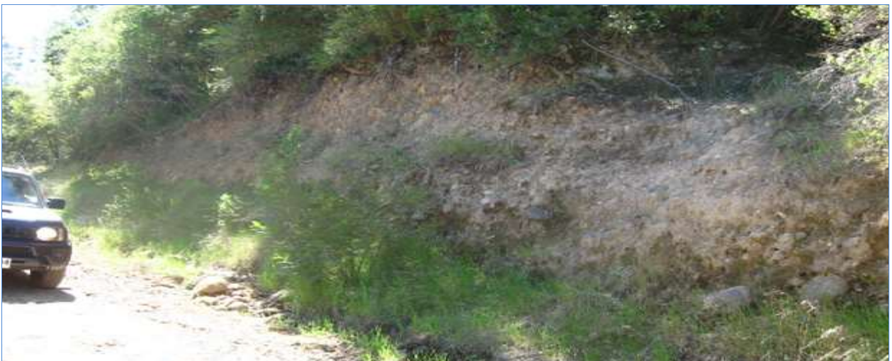
Figura 7C: Talud de corte en zona de pendiente fuerte.
