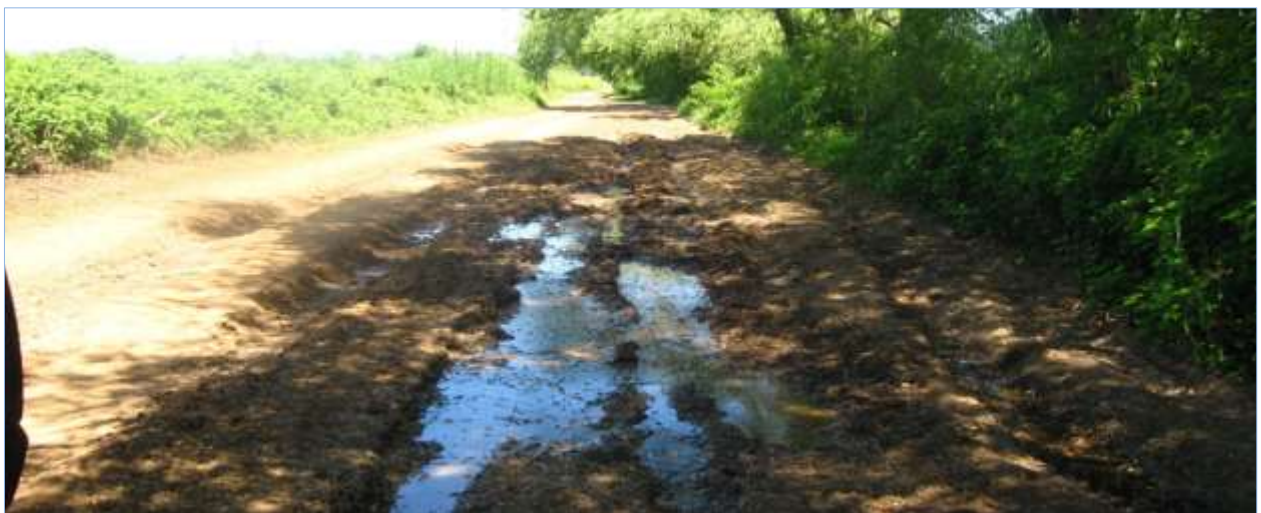
Figura A11: Condición superficie de rodado, km 0,710.
