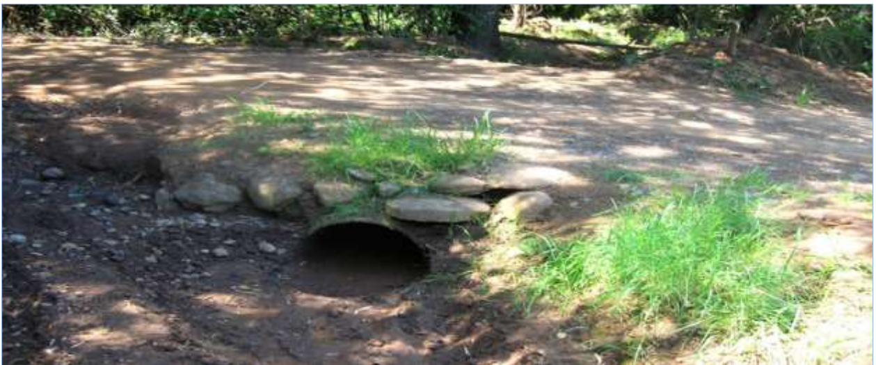
Figura A14: Tubería de acero en canal de riego no revestido, km 0,915.
