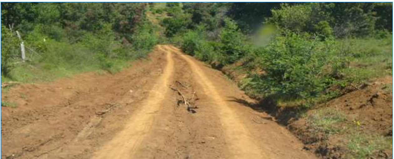
Figura 10C: Superficie natural de rodadura erosionada y presencia de cárcavas.
