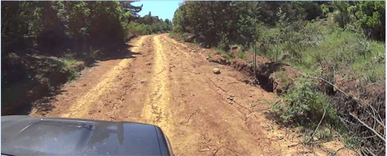
Figura A19: Estado de superficie de rodadura, presencia de erosión y cárcavas, km 1,170.
