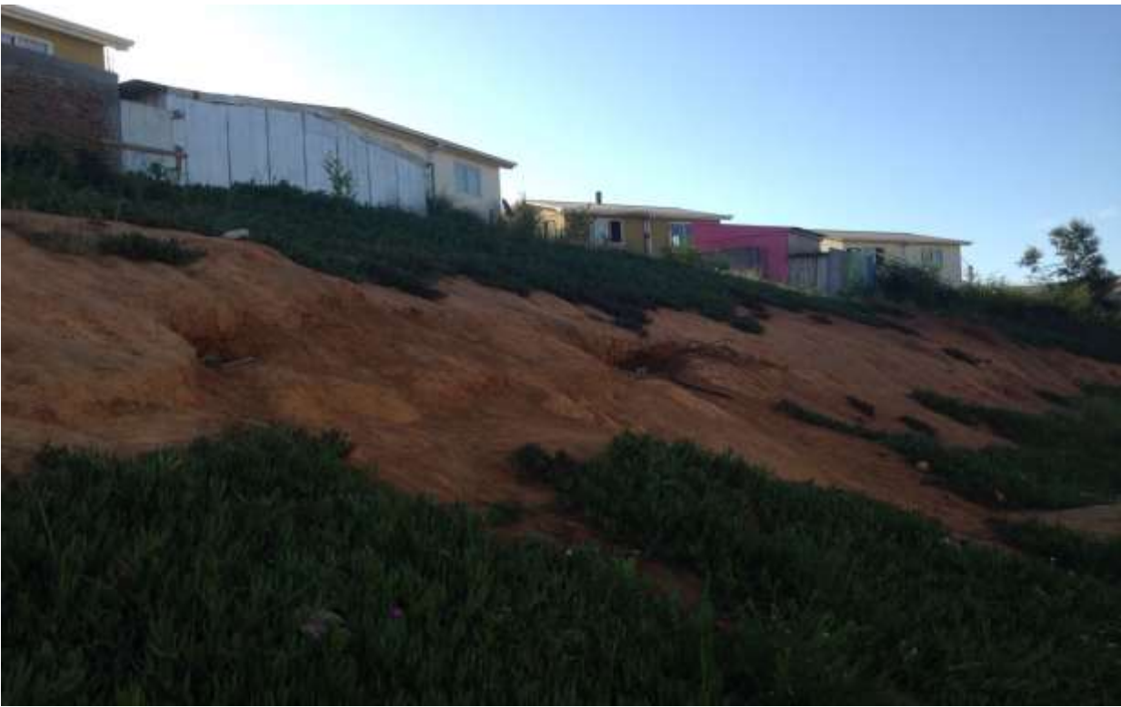
Talud PMP, Cárcavas, Elaboración Propia (2016). (9)
