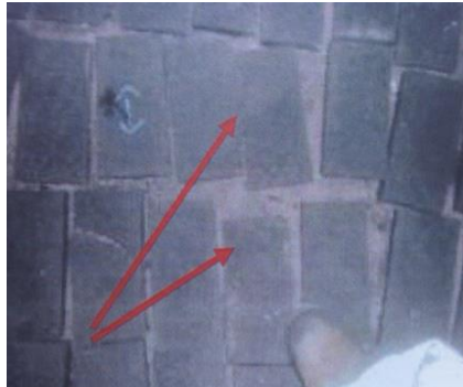
Figura 5. Ladrillos refractarios zona del piso fuera de posición.
