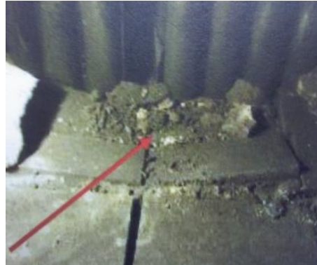
Figura 9. Detalle del desnivel y desprendimiento de refractario en zona del piso.
