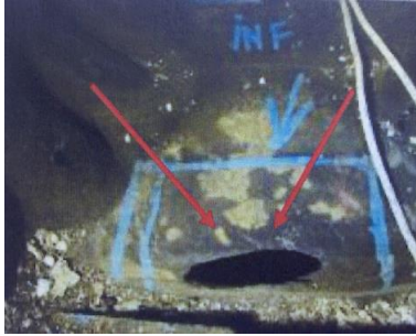
Figura 6. Rotura en membrana inferior del manhole.
