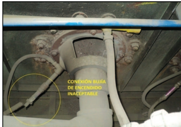
Fig.4.13 Estado sistema de ignición automático dañado
