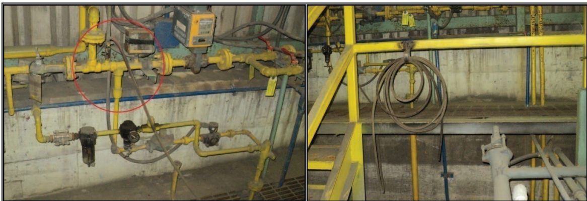
Fig.4.14 Manguera empleada para encendido de quemadores.
