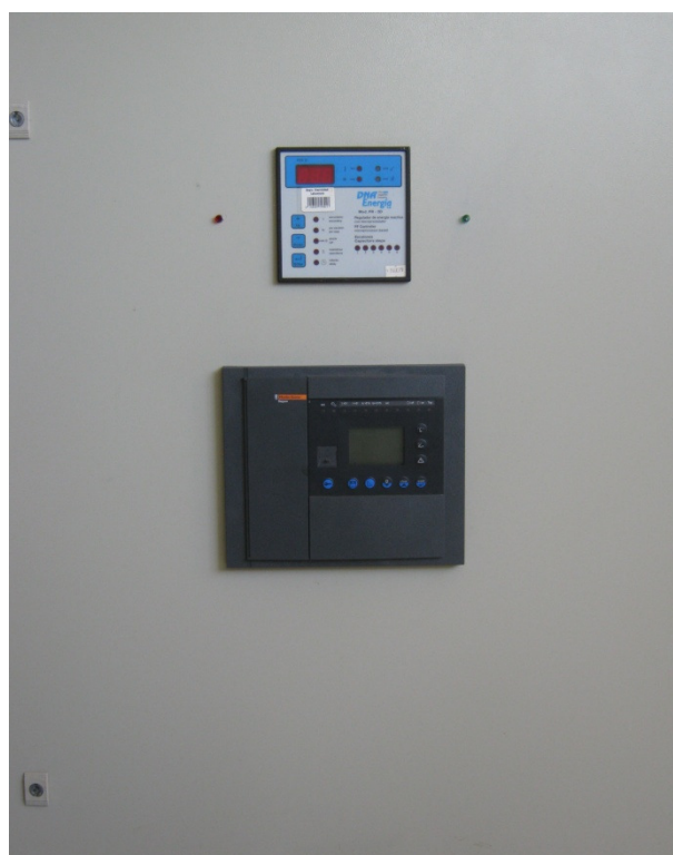
Fig. 3.2 Modulo acondicionado con protección SEPAM serie 80.
