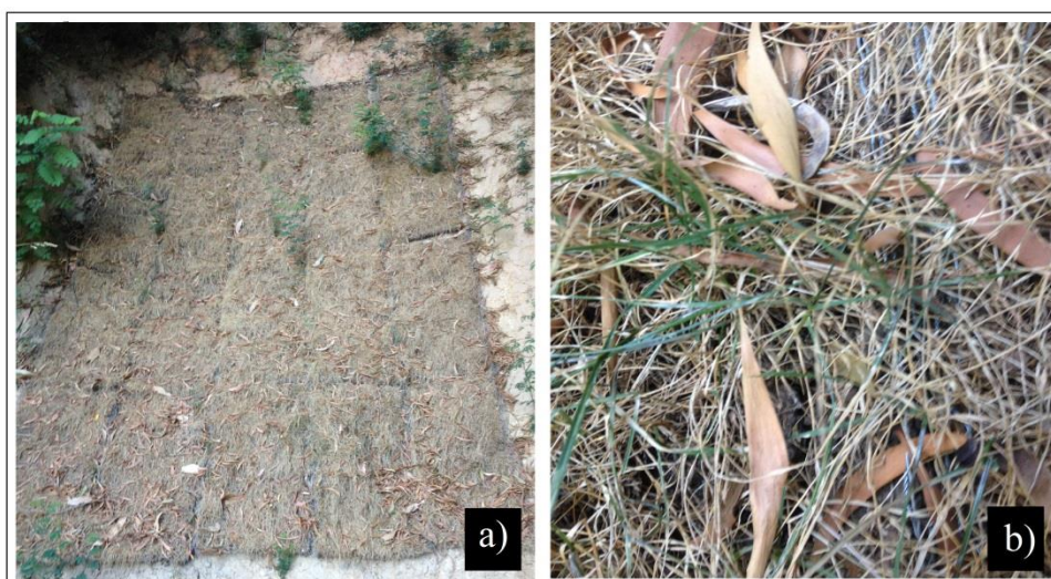
Figura 12. Recubrimiento sin mantención.
