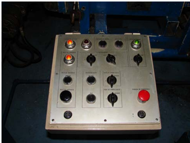
Fig. N°12: CP 24, control de Transportador 819 después de amarradora #1.
