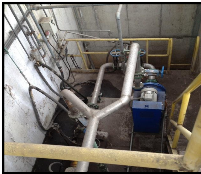
Figura 4.36: Bomba alimentación caldera
