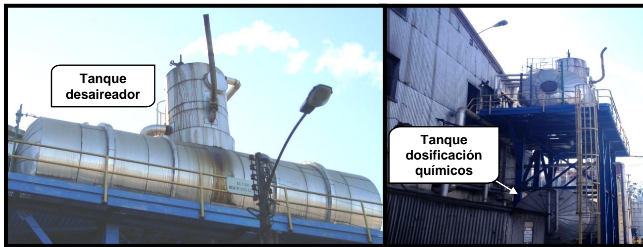
Figura 4.30: Tanque desaireador y dosificación de químicos.
