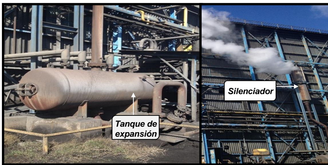
Figura 4.8: Tanque de expansión y su silenciador.
