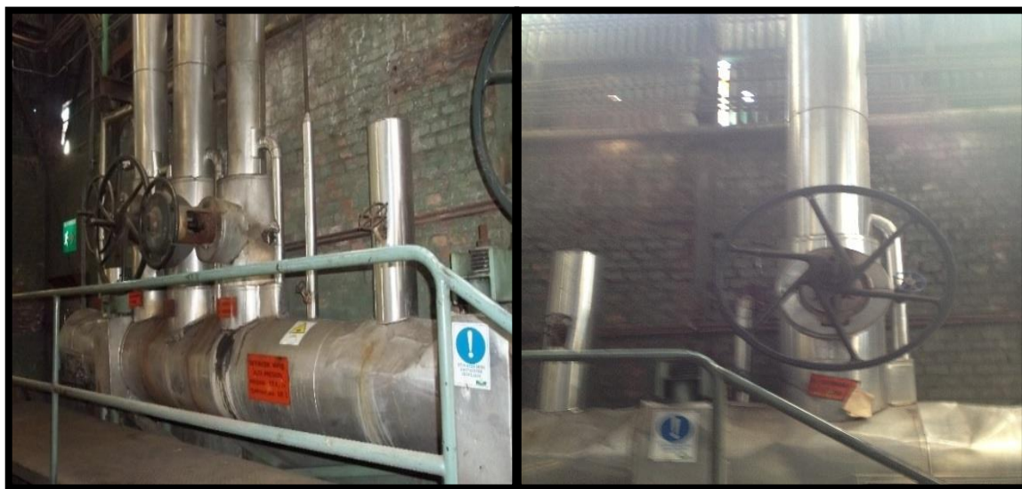
Figura 4.12: Distribuidor de vapor de alta presión.
