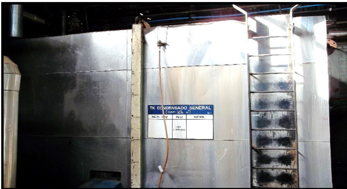
Figura 4.29: Estanque de condensados general
