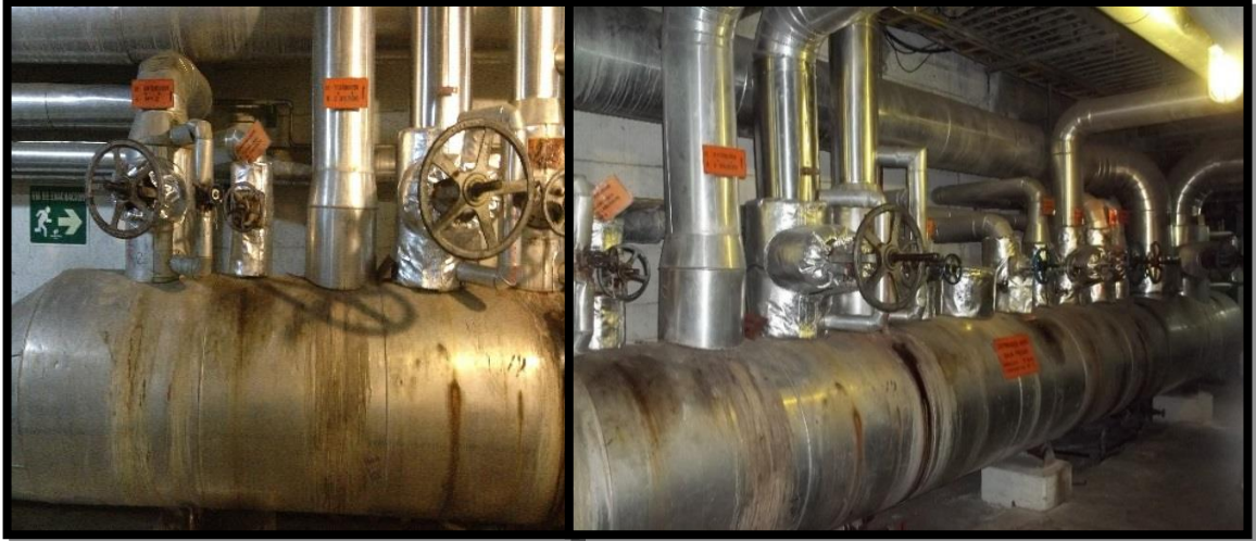
Figura 4.13: Distribuidor de vapor de baja presión.
