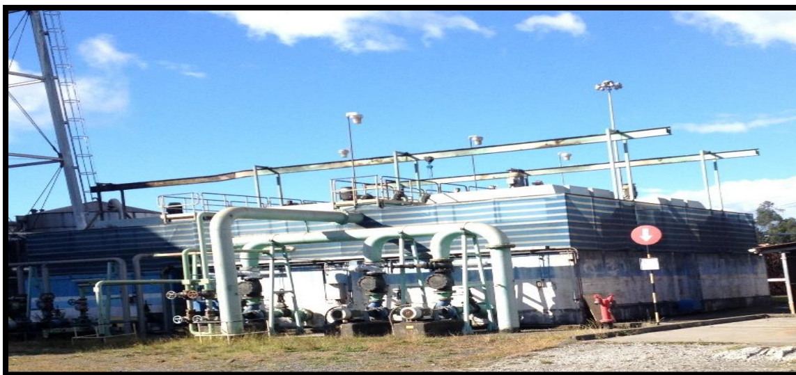
Figura 4.24: Torre de enfriamiento.
