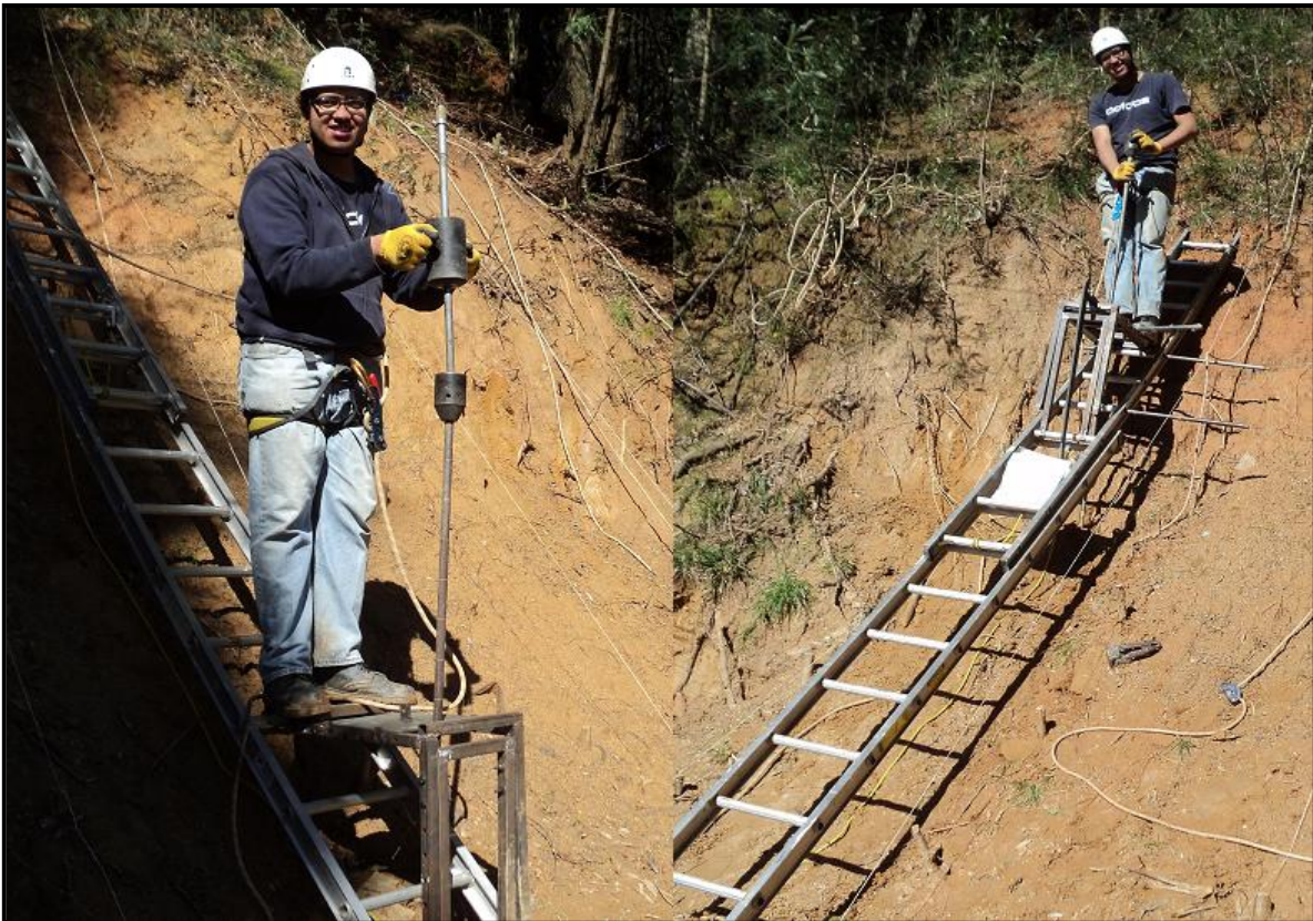
Figura J11: imágenes durante realización de sondajes en distintos puntos del talud.
