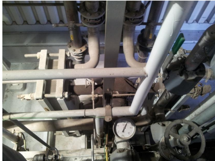
Figura 2-10: Enfriadores de aceite
