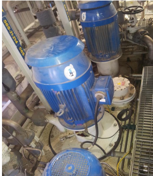
Figura 2-21: Bombas de lubricación.
