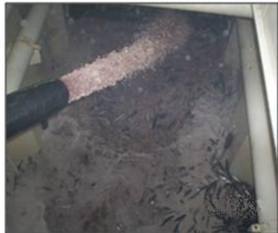
Agua utilizada en la descarga de los PAM, recuperada por el desaguador
