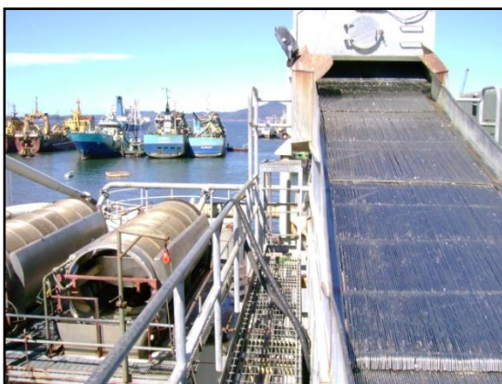
Desaguador de la torre de descarga, formado por varillas de acero inoxidable
