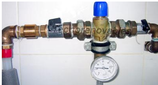
Figura N° 3.24. Válvula mezcladora termostática.
