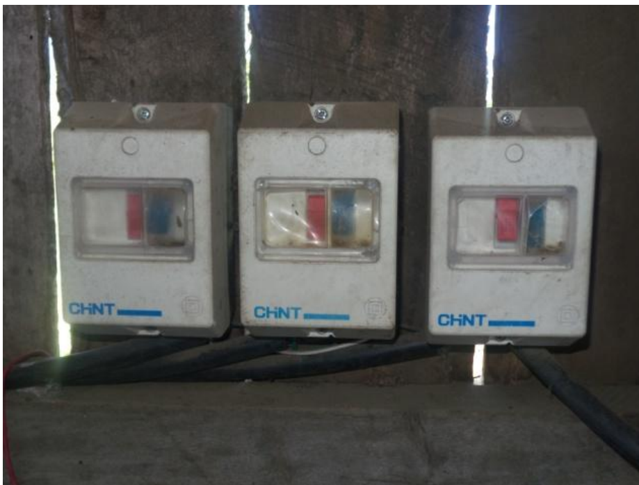
Fotografía 2.7 Botoneras On-Off de cada Moto Bomba.
