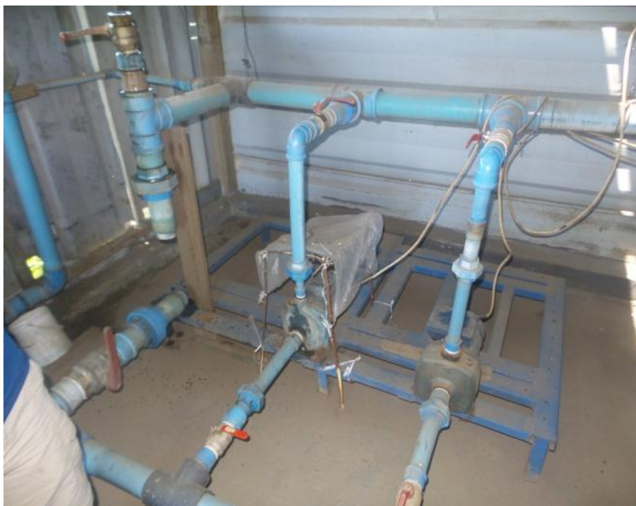
Fotografía 2.4 Grupo de Moto-Bombas (Motor C faltante, y no lo habilitarán más).
