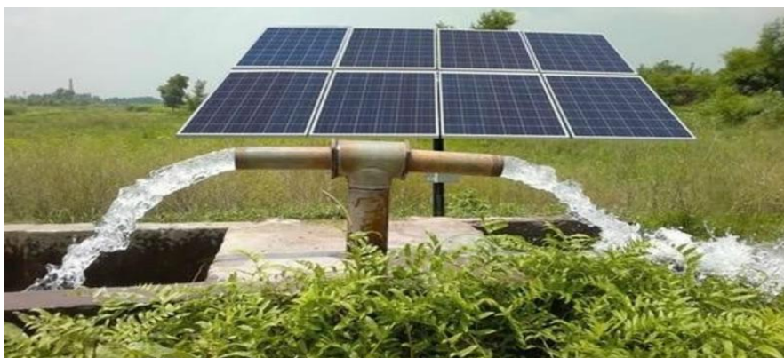
Figura 2.3 Sistema de bombeo de agua alimentado con un sistema Off-Grid.
