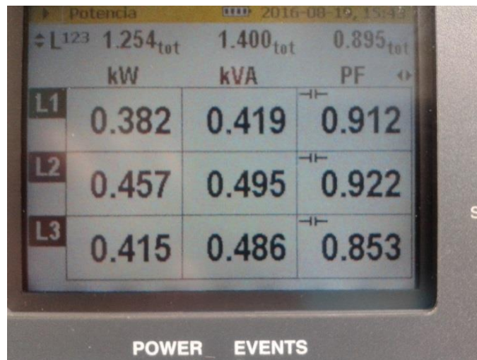
Figura 5.19 Potencias por fase, factor de potencia y potencias trifásicas.
