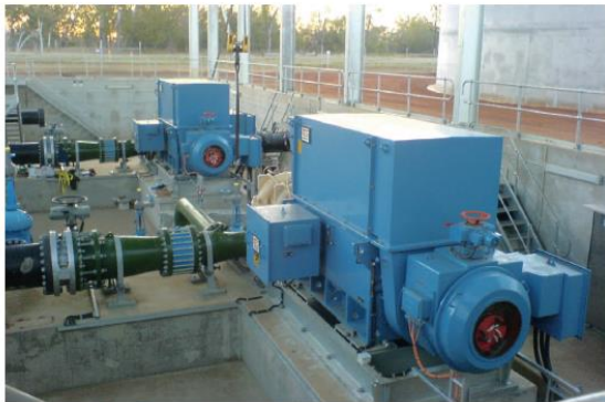
Aplicación: Bomba de agua 2.000 kW, 11.000 V, 4 polos, carcasa 560
