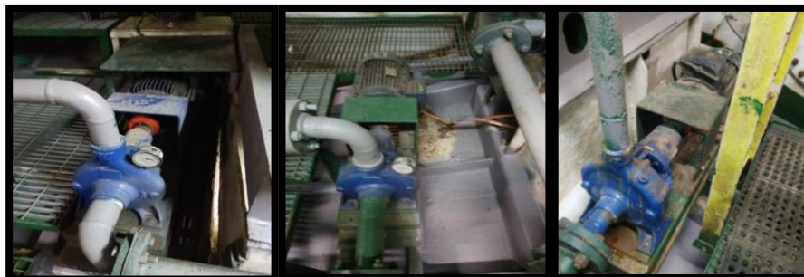
Imagen 4.1.c; Bombas de enfriamiento, Motores generadores N° 1, N° 2 y N° 3
