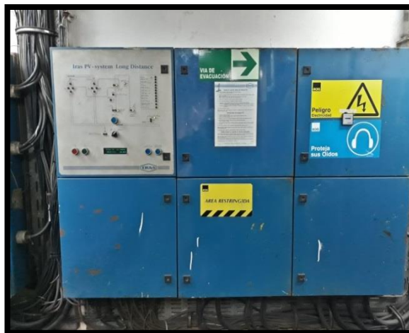
Imagen 4.2.a; Panel de control PLC
