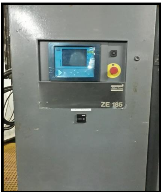
Imagen 4.2.b; Compresor de tornillo N° 1
