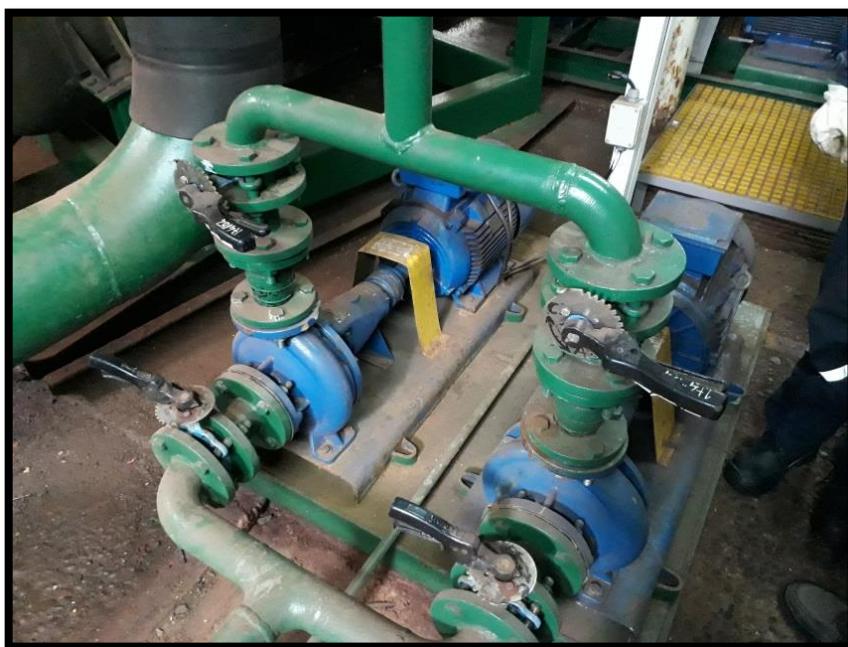
Imagen 4.3.c; Bomba red de incendio / Bomba de achique
