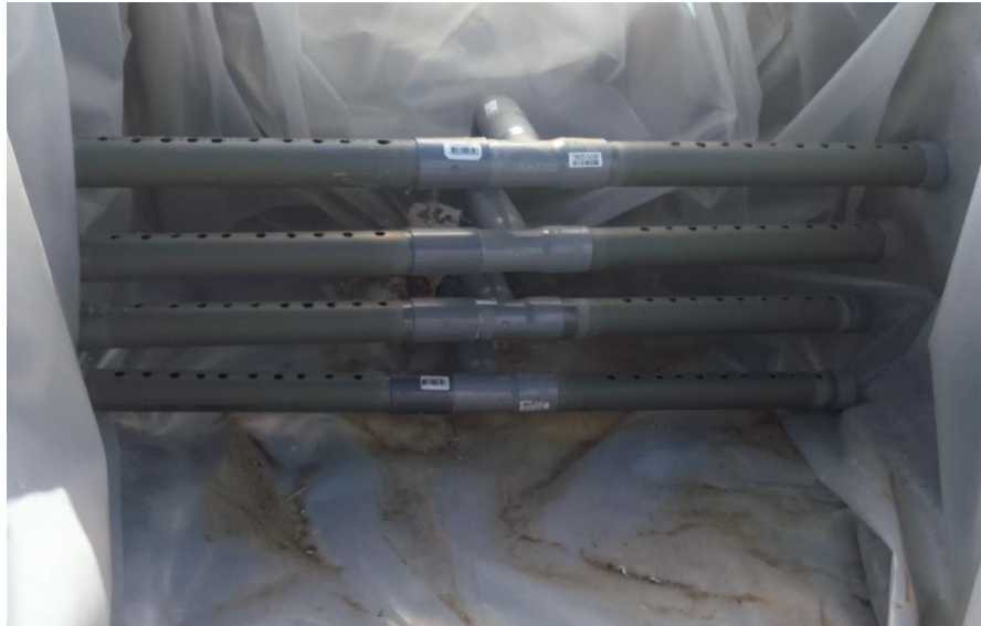
Figura B 5. Dispositivo de captación del afluente del humedal.
