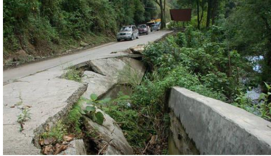
Figura N° 2 “Desplazamiento de suelo bajo carretera” (Fotografía extraída de la web)
