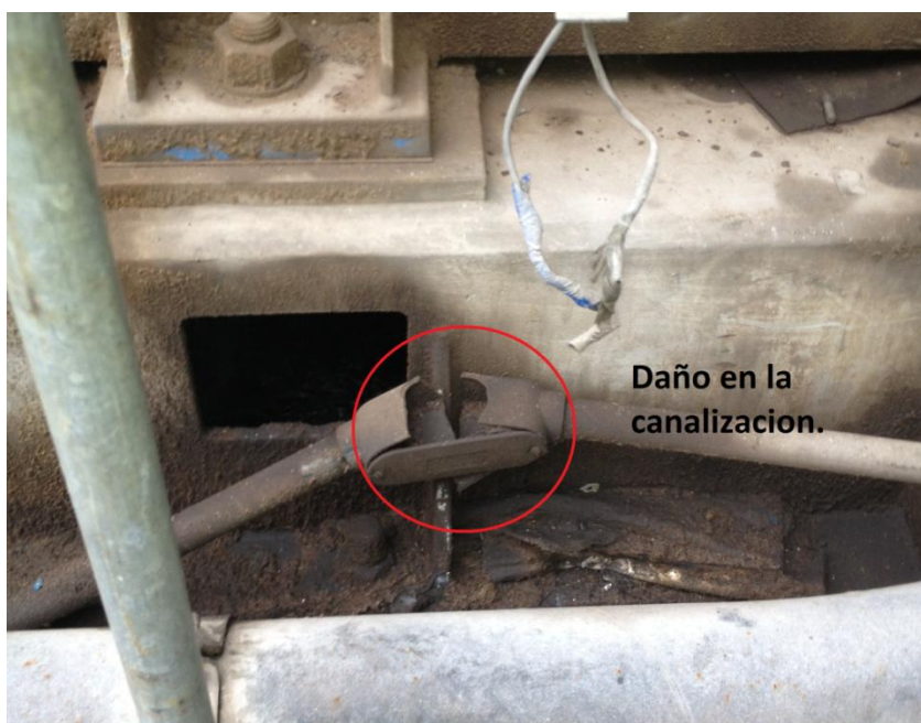
Figura 6.4, daño en la canalización.
