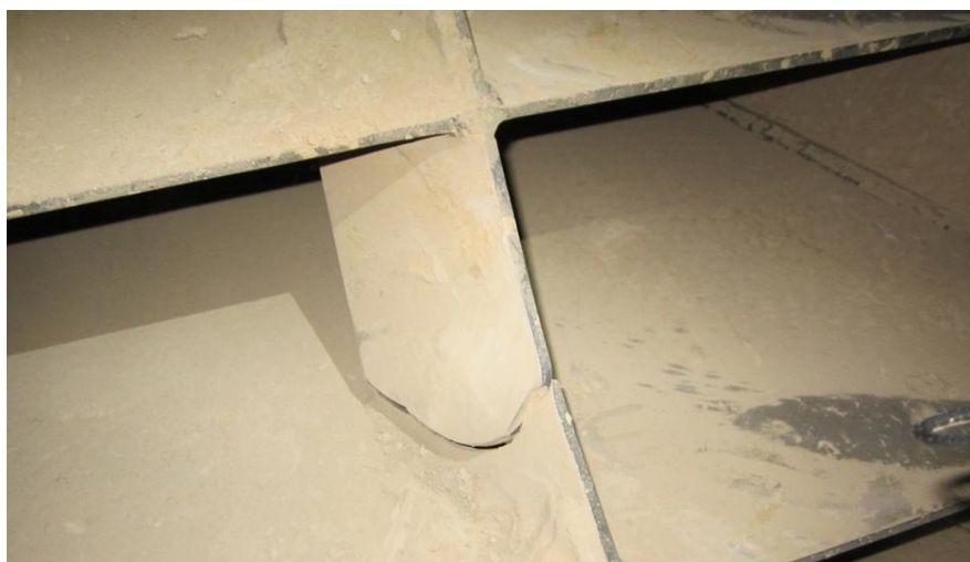
Figura 7.5, anillo agrietado del ventilador.
