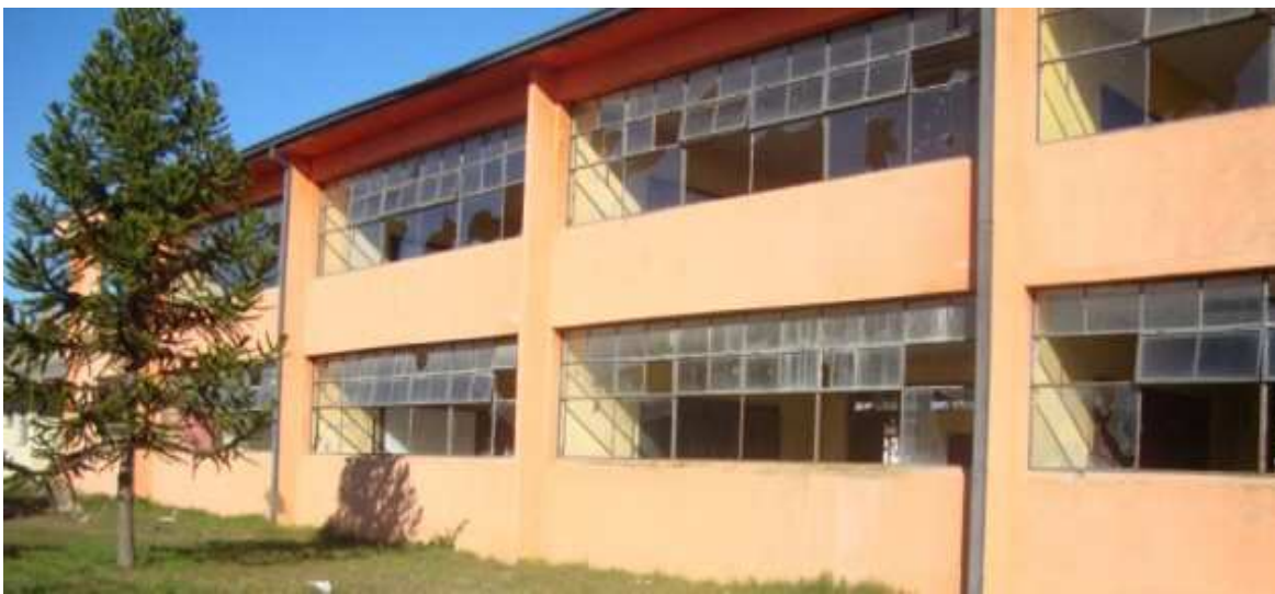
Fig. 2.2 Vista edificio post-terremoto, que se demolió
