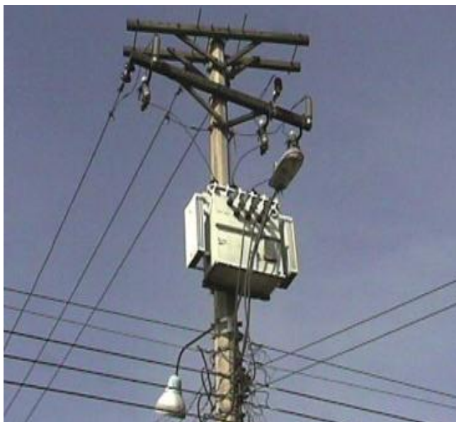
Figura 1.9. Subestación de distribución.
