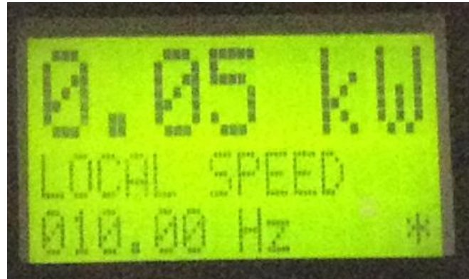
Fotografía 6-9: Detalle de Variador de Frecuencia programado para 10 Hz.
