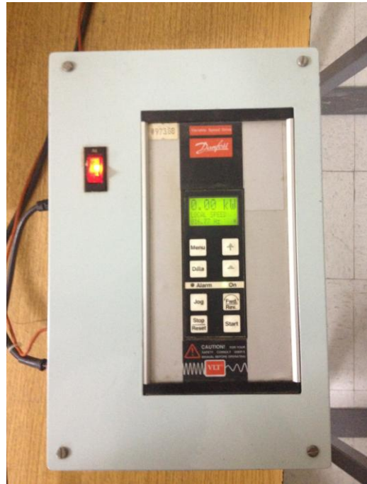
Fotografía 6-5: Variador de Frecuencias.
