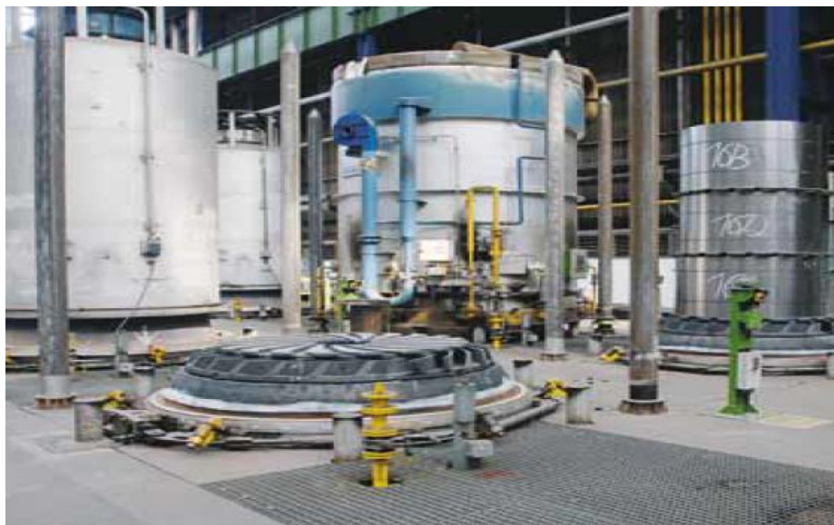
Figura N°3.3.3.5a, Horno de campana.
