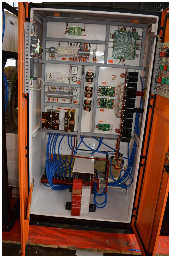
Figura N° 4.3 Interior del generador eléctrico.
