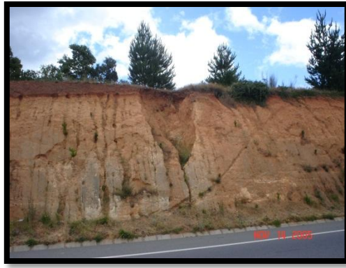
Figura N° 5: Signos de deterioro en un talud.
