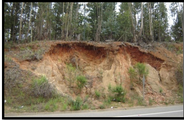
Figura N° 4: Efecto de la erosión en talud (Camino la Pólvara, V Región).
