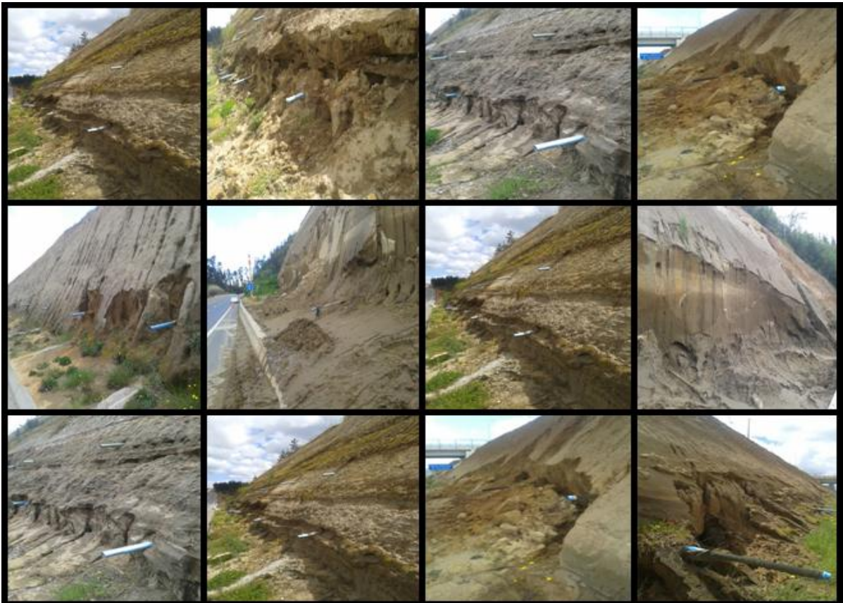
Figura E2. Formas de falla subdrenaje horizontal (Fuente: Propia)
