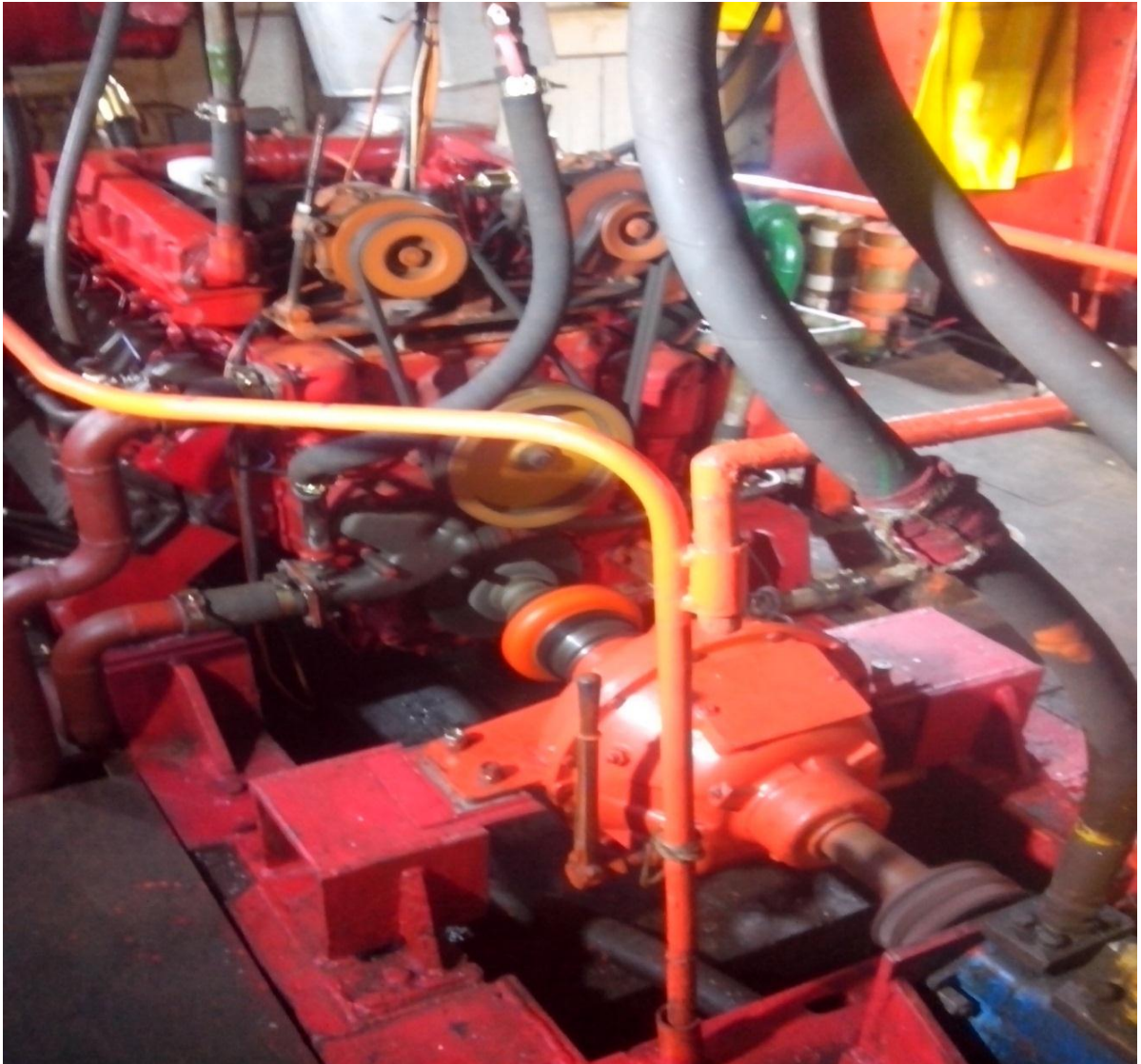
Imagen 1.3 Sala de máquinas.
