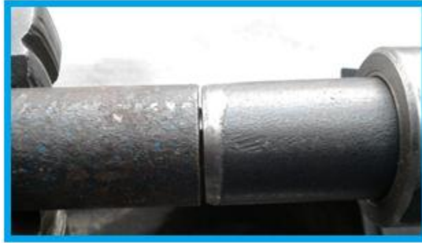
Figura 4.3 Montaje de las piezas a soldar, distancia en voladizo 30 mm cada extremo.
