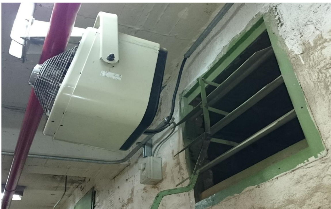
Figura 7.1 Condición actual del dámper de entrada.
