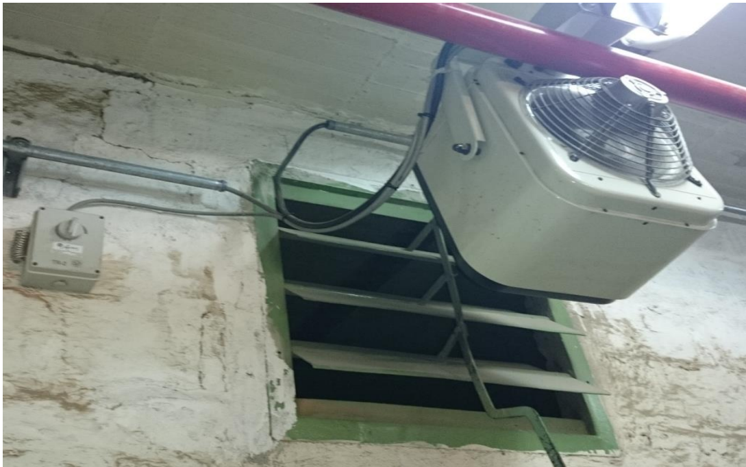
Figura 4.12 Termo-ventilador junto al dámper de entrada aire.
