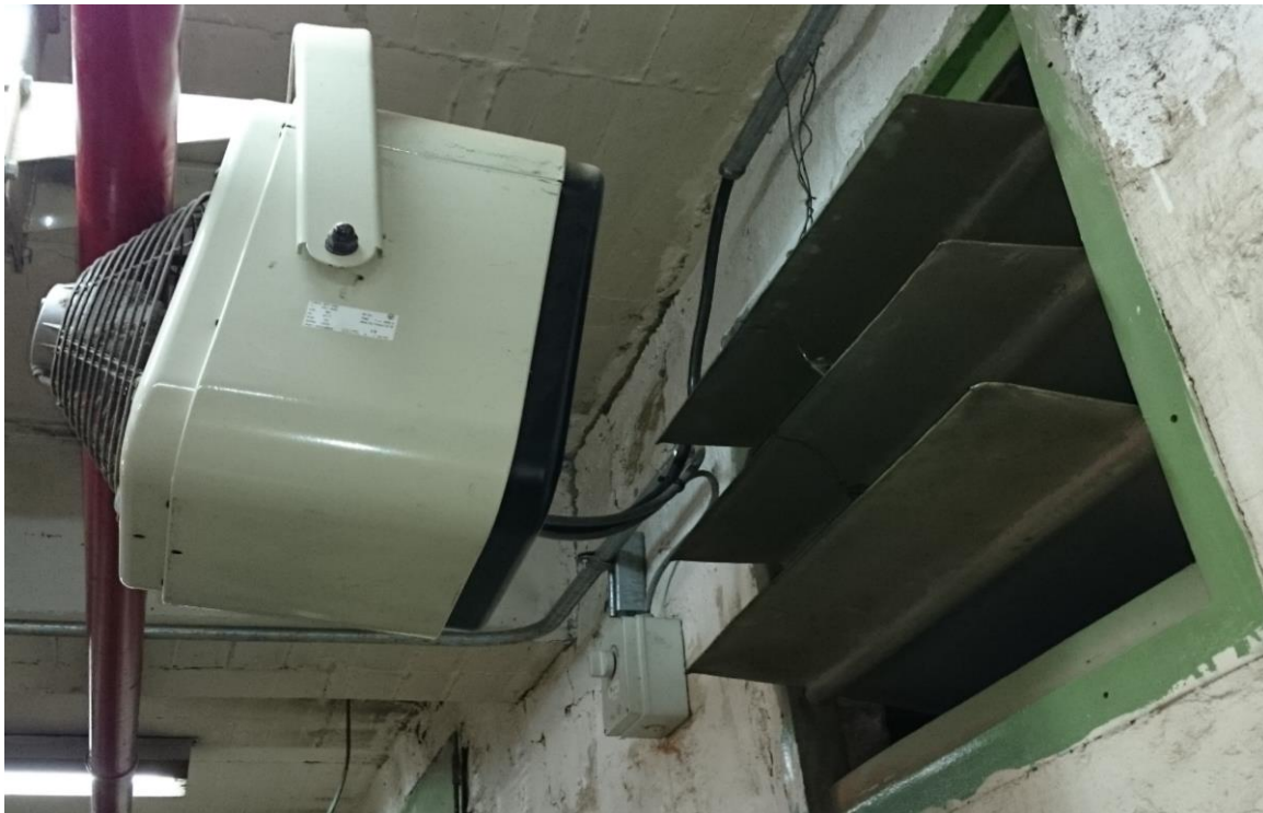
Figura 7.2 Dámper de entrada de aire del termo ventilador.
