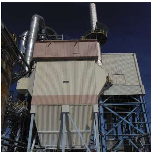
Fig. 2.7 Precipitador con tolva de Horno de Cal
